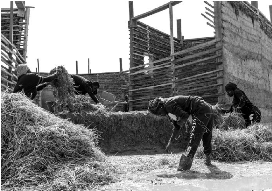
Mujeres y construcción sostenible en el polo de desarrollo Tabax Nité de Gandiol, Senegal
